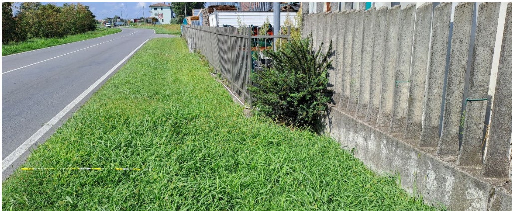
Foto dislivello dovuto a presenza piccolo torrente passante lungo tragitto ciclabile
